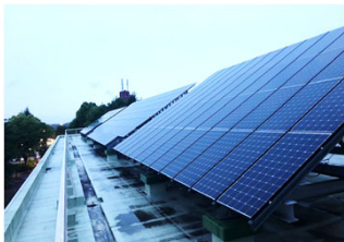
創エネルギー設備の整備
