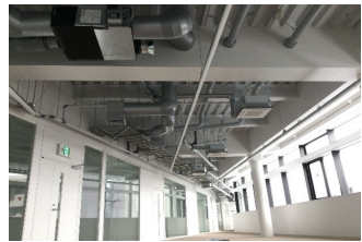
高効率空調の整備
