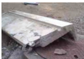
手すりが破損し落下
