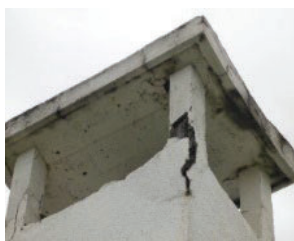
屋上煙突のモルタル剥離
