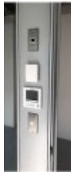
自然換気表示ランプ
