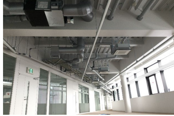
空調・換気設備
