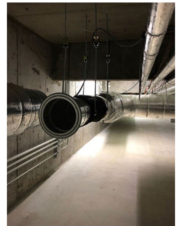
地下ピット内の換気吸入口
