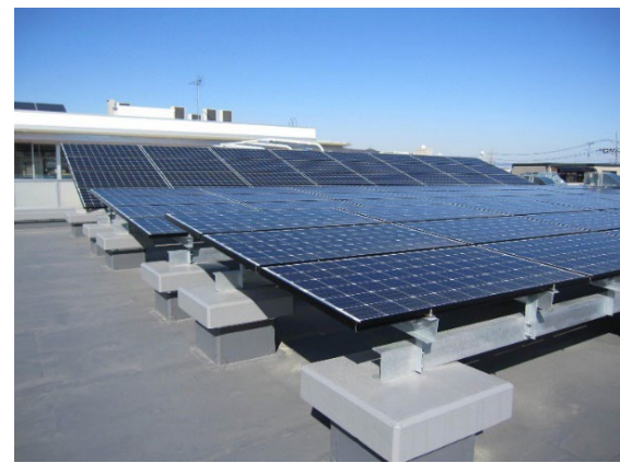
太陽光発電設備
