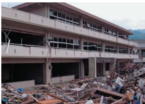
津波により被害を受けた校舎
