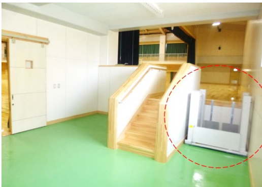
屋内運動場ステージ袖に設置された段差解消機
