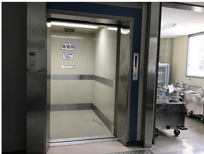
改修前の人荷共用エレベーター
