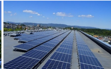
南校舎屋上太陽光パネル
