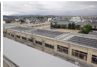
校舎屋上太陽光パネル
