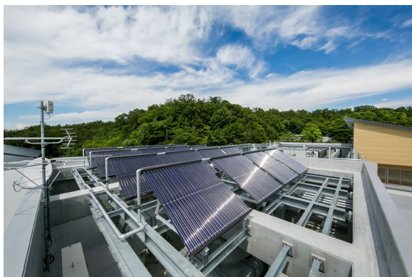
最大200kWh/日の太陽熱集熱ユニット (空調・給湯利用) (愛知県瀬戸市立にじの丘学園)
