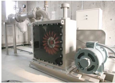
水中タービン発電機 (福井県南越前町立南条小学校)
