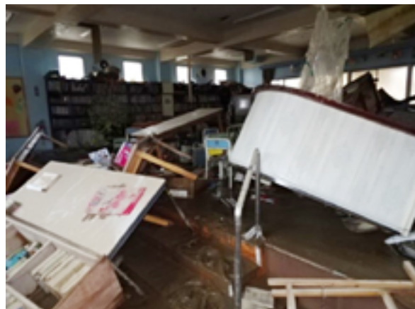
大雨による浸水により被災した学校施設
