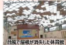
台風で屋根が消失した体育館
