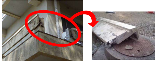
老朽化により手すりが落下
