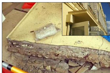
校舎出入口の庇（約800kg）が落下
