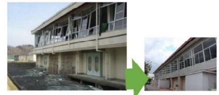
地震によりガラスが落下
