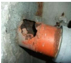
劣化による配管破損
