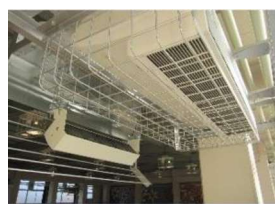
◆体育館に設置された空調設備
