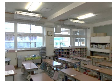
空調設備・換気設備を備えた教室
