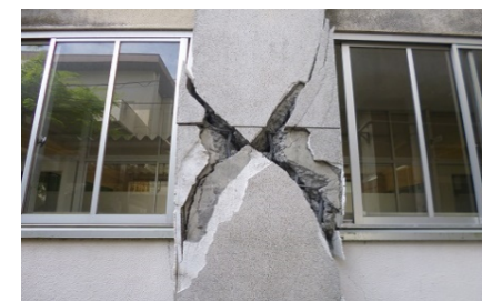
耐震化未完了の建物が大規模地震で甚大な被害を受けた例
