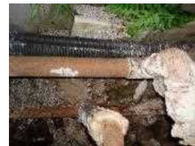
排水設備 (劣化状況)
