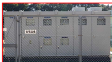
給水施設受変電施設
