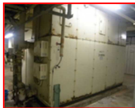
JT-60整流器棟空調機
