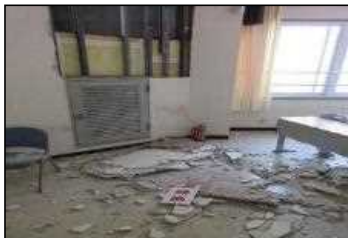
地震による内部破損
