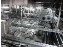
高浄度空調更新
