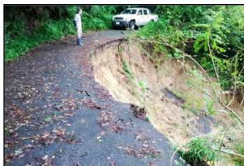
大雨による法面崩壊
