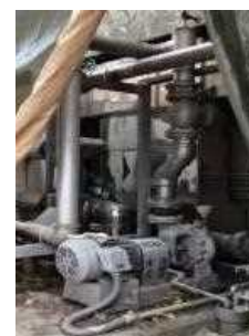
空調設備 (劣化状況)
