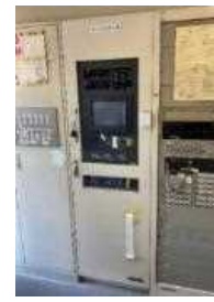
火災報知設備
