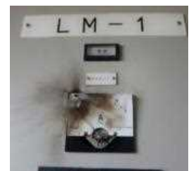
配電盤がショート
