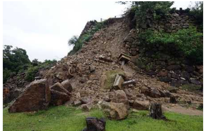
史跡 洲本城跡（兵庫県洲本市） 令和3年8月豪雨による被害
