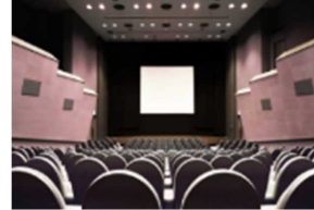
来館者の安心安全に資するため上映ホールの特天天井等にかかる脱落防止対策を実施
