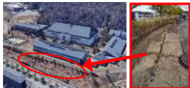
構内道路に発生した地割れ
