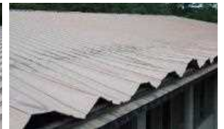
屋根全面が波打っている
