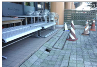
地震による外構破損
