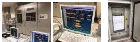
中央監視システム
