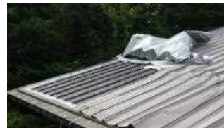
体育館屋根が損傷（漏水が発生）
