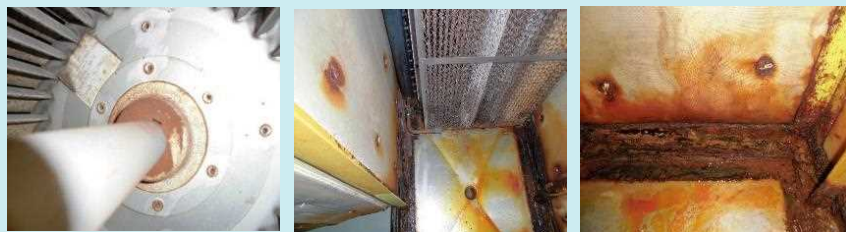
空調機器内部底面のフレーム部及び給気ファンの腐食等への対応
