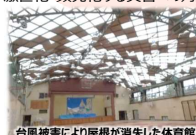
台風被害により屋根が消失した体育館
