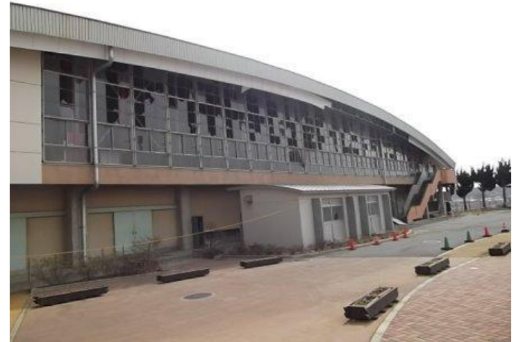
東日本大震災（H23.3.11） 屋内運動場の大開口部のはめ殺し窓の破損
