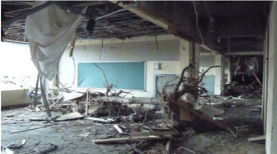
東日本大震災（H23.3.11） 津波の水圧により壁が喪失した教室
