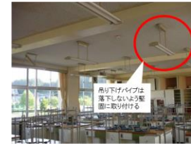
写真1 吊り下げ照明器具（教室）
