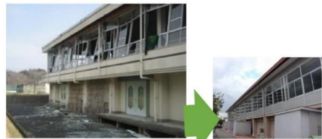
地震によりガラスが落下
