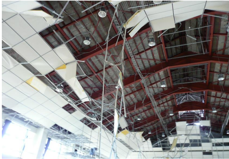
東日本大震災（H23.3.11） 屋内運動場の天井材の落下
