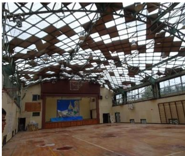
令和元年台風 屋内運動場の屋根の破損
