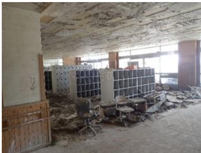
平成30年7月豪雨 校舎への床上浸水
