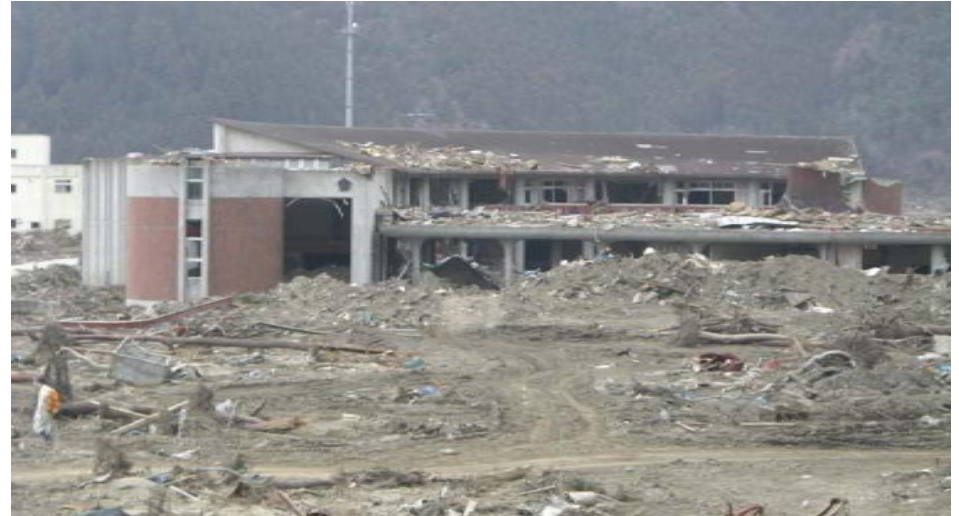
東日本大震災（H23.3.11） 津波の水圧により壁が喪失した校舎
