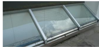
写真1 窓ガラスのひび割れ
