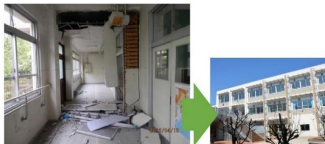
老朽化により天井や壁の一部が落下
