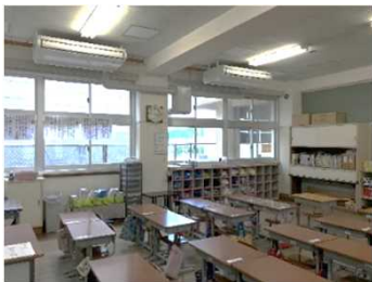
【空調・換気設備を備えた教室】
