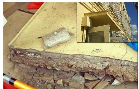
校舎出入口の庇(約800kg)が落下
