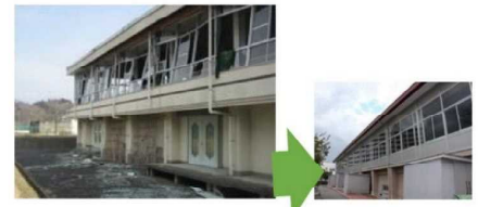
地震によりガラスが落下
