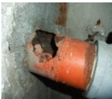
劣化による配管破損
