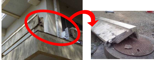
老朽化により手すりが落下
