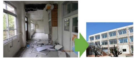
老朽化により天井や壁の一部が落下
