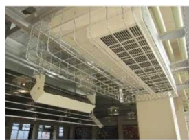
◆体育館に設置された空調設備
