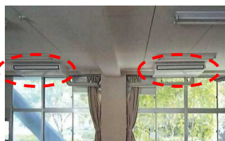
◆普通教室に設置された空調設備 ※滋賀県湖南市提供
