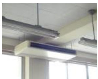
▲普通教室に取り付けられたエアコン
