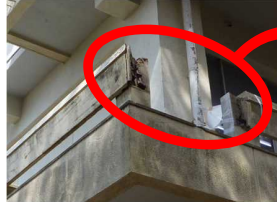
老朽化により手すりが落下
