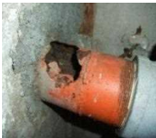
劣化による配管破損
