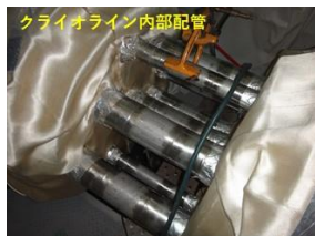
クライオライン内部配管
