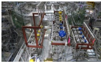
冷媒系安全弁ユニット
