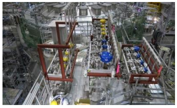
冷媒系安全弁ユニット
