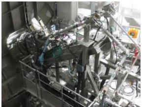
電子サイクロトロン加熱導波管
