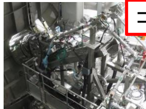
電子サイクロトロン加熱導波管
