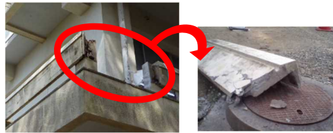
老朽化により手すりが落下
