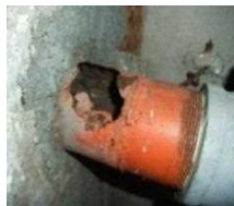
劣化による配管破損
