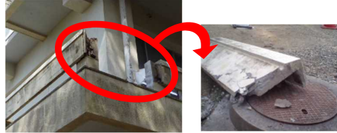
老朽化により手すりが落下
