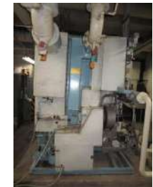
吸収式冷温水発生機 (チューブ内の腐食が激しい)
