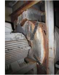
外調機劣化によるトラブルが頻発
