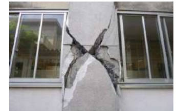
耐震化未完了の建物が大規模地震で甚大な被害を受けた例
