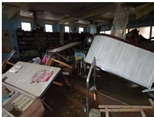
校舎の床上浸水
