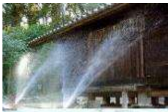
(ドレンチャー設備)
