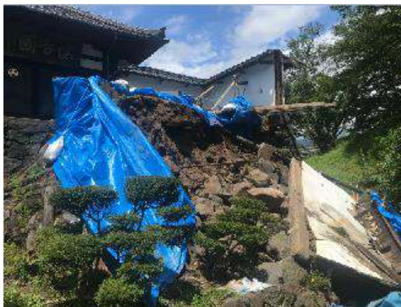
重要文化財 小諸城三之門 (長野県小諸市) 令和2年7月豪雨による塀の崩壊
