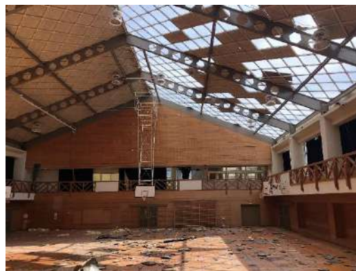
体育館屋根の破損
