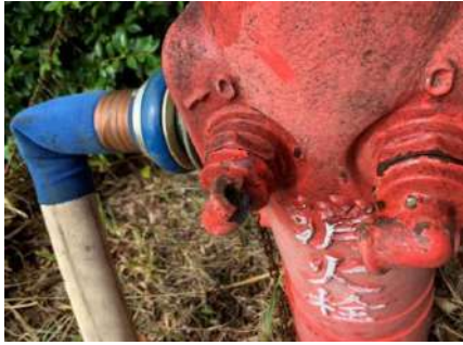
老朽化設備例
