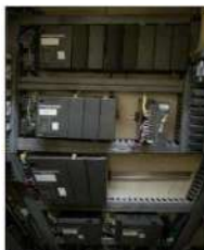
空調制御盤内
