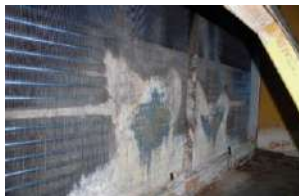
空調機内部の腐食・目詰まり
