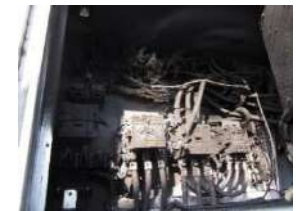
空調設備の配線劣化による焼損
