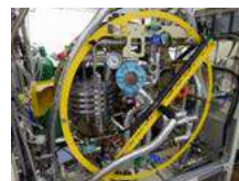
O2製造装置 (環境制御・生命維持技術の例)
