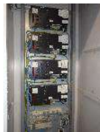
照明制御設備
