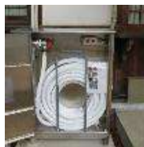
(易操作性1号消火栓)
