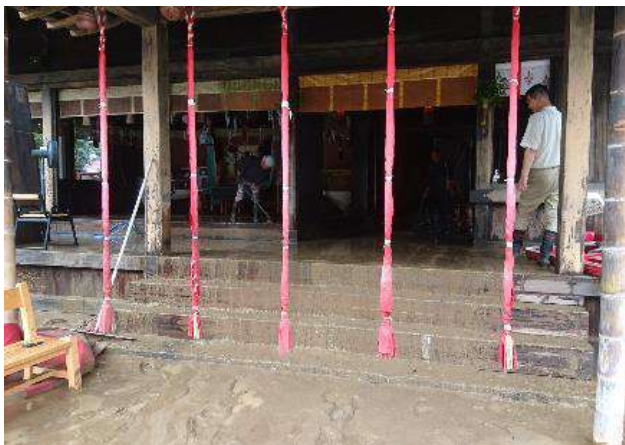
国宝 青井阿蘇神社本殿 (熊本県人吉市) 令和2年7月豪雨による毀損
