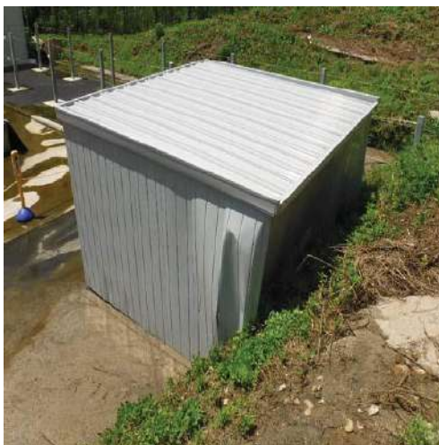
令和2年7月豪雨により法面が崩壊し物置が損壊
