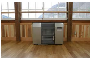
冬季の暖房として木質ペレットストーブの採用
