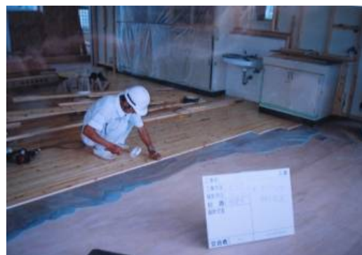
通常の施工 モルタル仕上げ面に下地合板を張り、床材を施工（玉川中学校）
