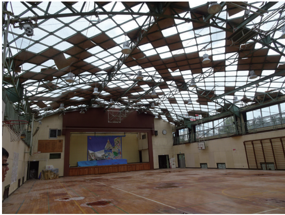
令和元年房総半島台風(台風第15号)で生じた 屋内運動場屋根ふき材等飛散
