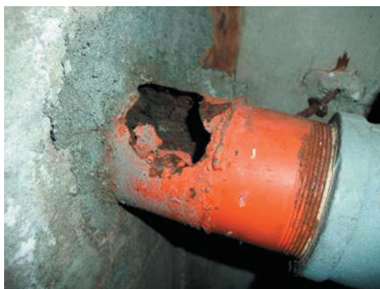
劣化による配管破損
