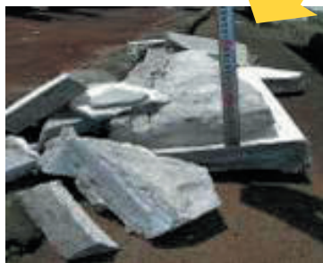
老朽化によりモルタルが落下
