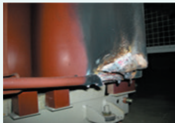
変圧器の発火による損傷
