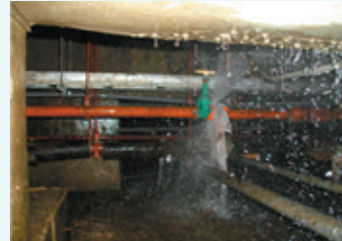
配管からの漏水
