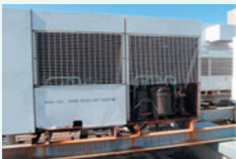
空調機の内部劣化
