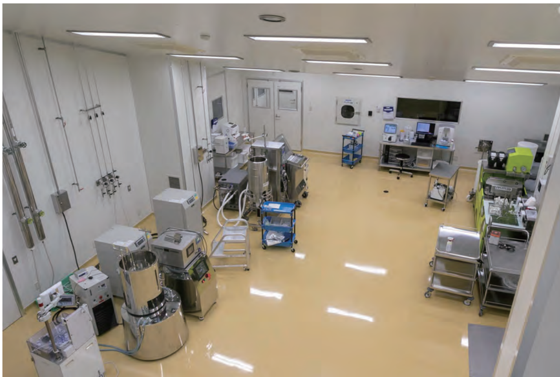
2階見学通路から1階製造検証施設(培養室)を望む(傾斜した天井内がISS)
