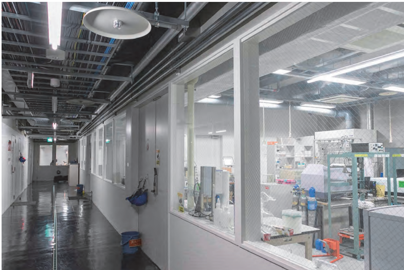
地下1階に集約した実験室
