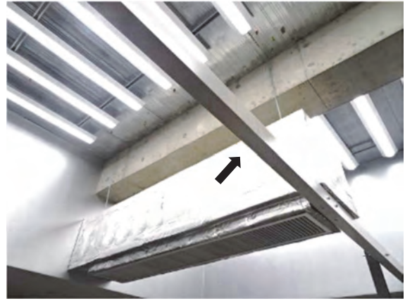
照明器具と耐震フレーム
