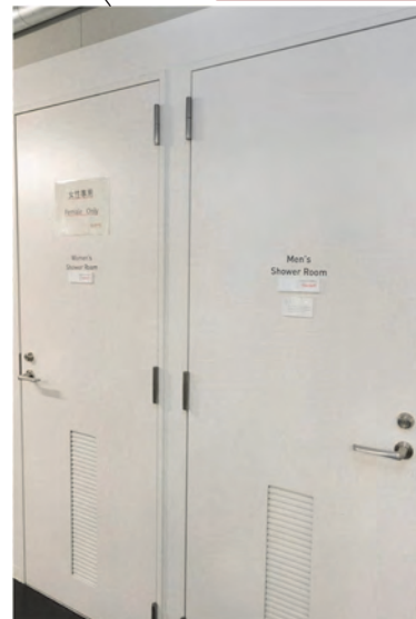
コンタミネーション対策用のシャワー室
