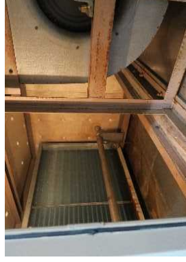
【空調設備(送風機)】
