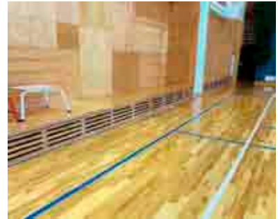
体育館のファンコン吹き出し口
