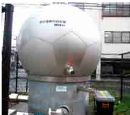
貯水機能付給水管
