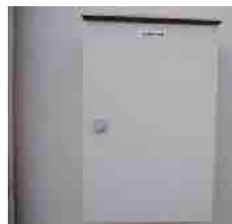
外部からの電源接続盤
