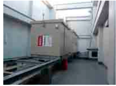
3階に設置された非常用発電施設
