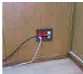
太陽光発電からの受電コンセント
