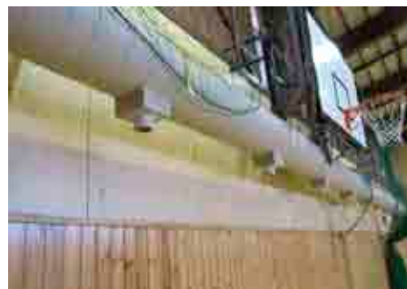
体育館の温風吹き出し
