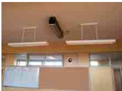
教室側の空気循環装置
