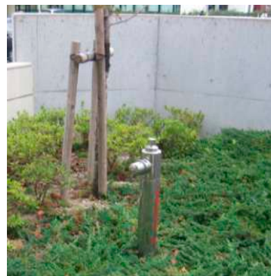
敷地内の応急給水栓
