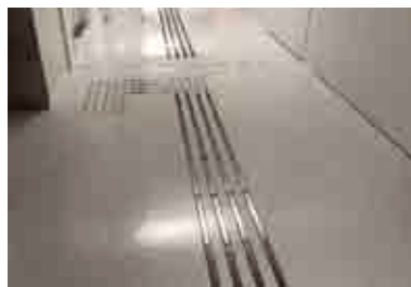
廊下に設置された誘導用点字錨
