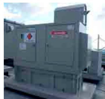
騒音防止と浸水対策として屋上に設置された発電機
