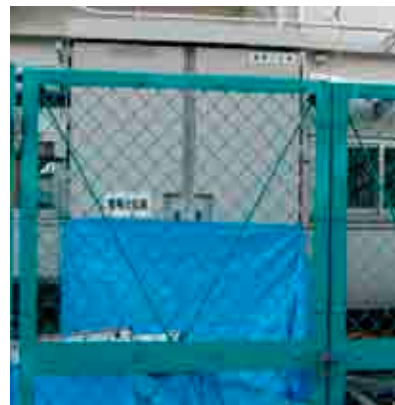
蓄電システム装置
