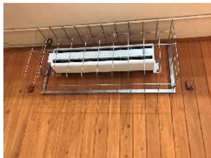
換気や館内温度安定化を図る送風機
