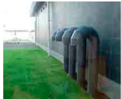
地中熱換気システムの吸気口
