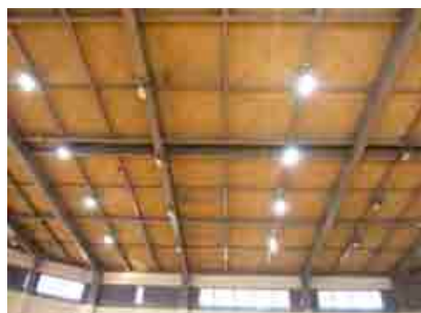
体育館のLED照明
