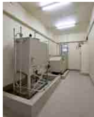
騒音対策された発電機室
