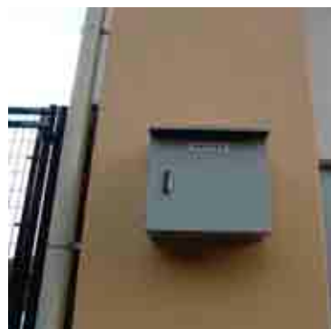
非常用発電機接続盤
