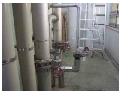
プール水の地上部分の蛇口
