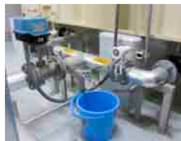
受水槽に取り付けた蛇口
