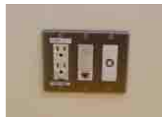
非常時用コンセント
