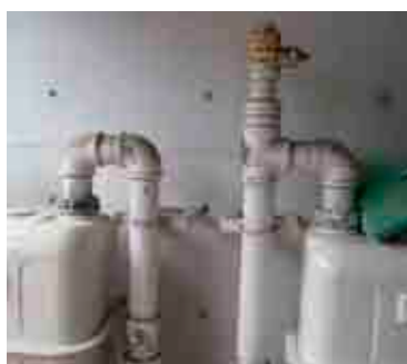
ガス変換機の接続口
