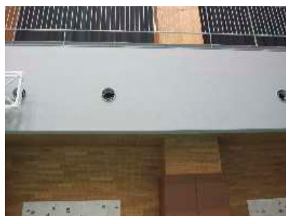
空調用の吹き出し口
