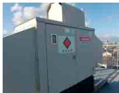
屋上に設置された自家発電機
