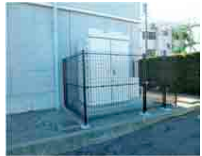
蓄電システム装置
