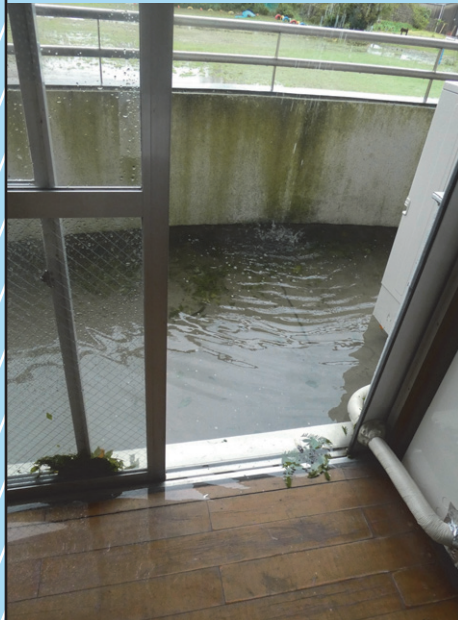
バルコニーからの浸水
