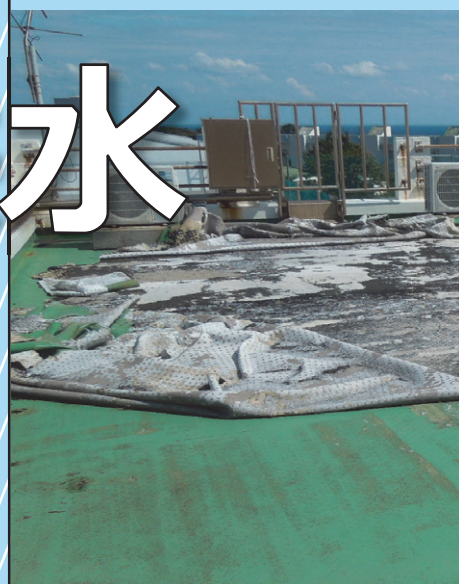
屋上防水が剥がれ室内が水浸し
