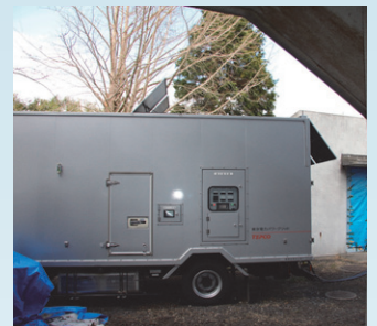
電源車の配備
