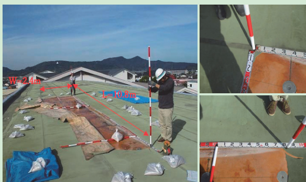
屋上防水シート被災箇所の計測 (始点と終点)
