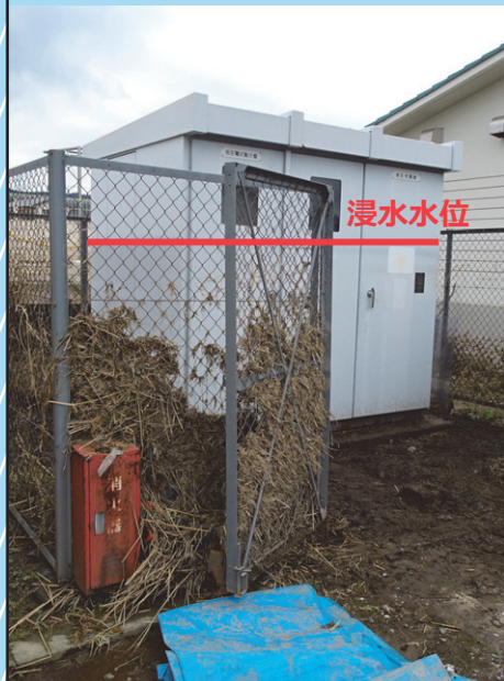
受変電設備(キュービクル)浸水
