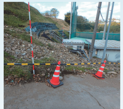
土砂崩れに対する立入禁止措置
