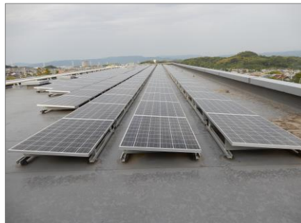
太陽光発電設備
