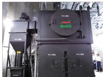
木質チップボイラー
