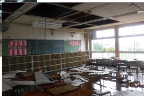
暴風により窓ガラスが破損し、雨風が吹き込み、天井や床に被害
