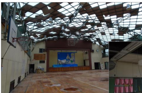
屋内運動場屋根葺き材飛散
