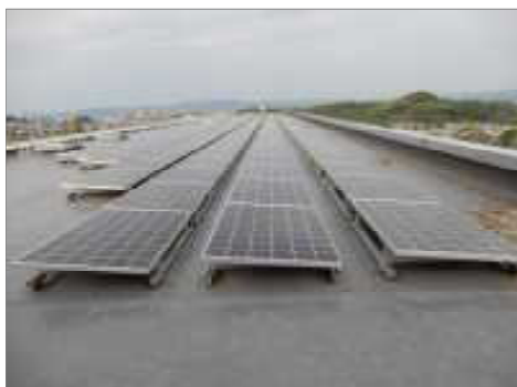
太陽光発電設備
