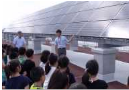
校舎屋上に設置された太陽光パネルを環境教育の教材として活用 (北海道江別市立江別太小学校)
