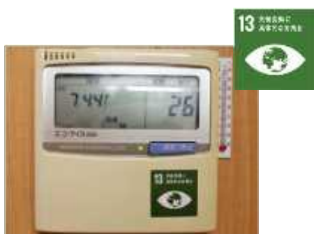
各教室のエアコンスイッチ
