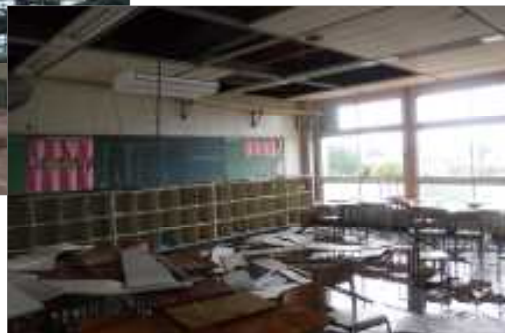
暴風により窓ガラスが破損し、雨風が吹き込み、天井や床に被害
