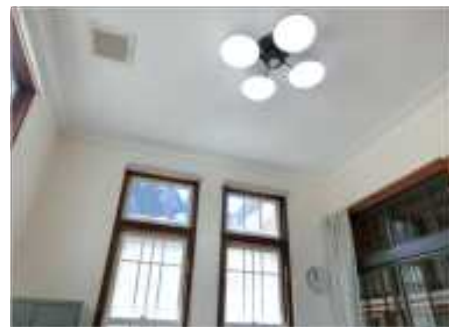
内壁や天井に改修前にも使われていた漆喰を採用（愛媛県伊予市立翠小学校）
