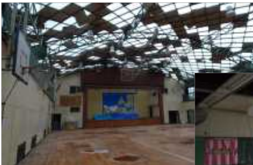
屋内運動場屋根葺き材飛散
