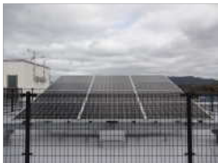
太陽光発電設備
