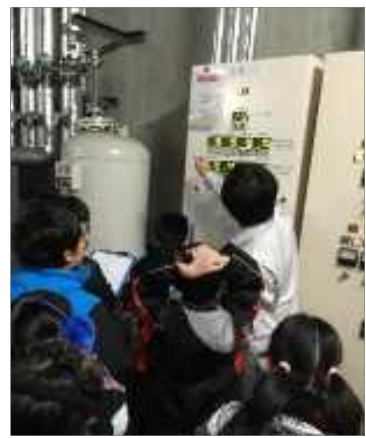
チップボイラー見学の様子
