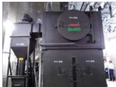
木質チップボイラー
