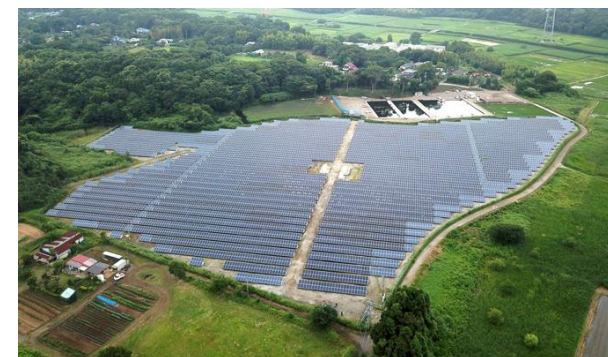
メガソーラー野田発電所 (2.88MW, 4.68ha)
