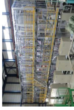
連続水素製造試験装置
