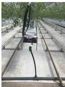
施設園芸場における液体肥料供給システム
