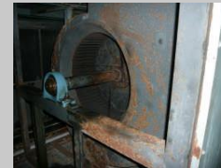
空調機内部劣化
