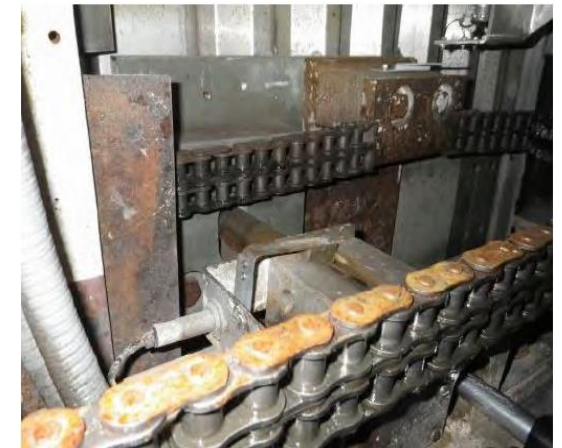
ドームメインシャッター 駆動系の老朽化・歪みで 誤作動が発生、駆動系の 調査・改修が必要
