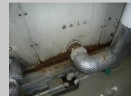
空調機から漏水
