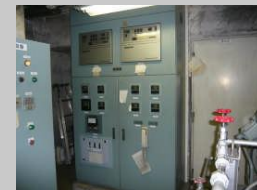
旧式自動制御盤
