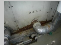
空調機から漏水
