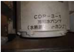
冷却水ポンプ
