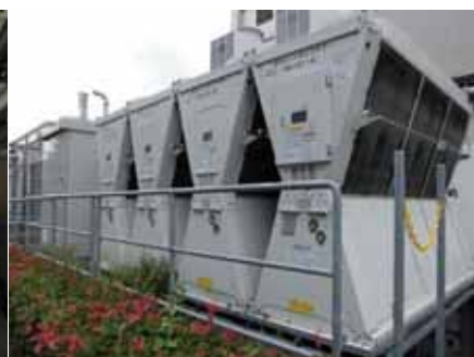
高効率空冷チラー(動物実験施設)
