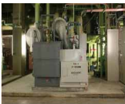
図9 熱回収ターボ冷凍機 (附属病院)
