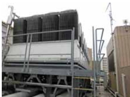
高効率空冷チラー(東病棟)
