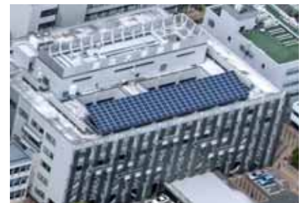
病院の太陽光発電パネル
