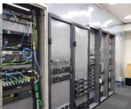
図11 簡易コンテナなどの 空流対策を施したサーバ室
