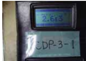
超音波流量計にて流量実測
