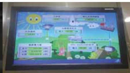
発電データ表示装置
