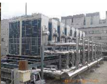
図10 空冷モジュールヒートポンプチラー (工学部1号館)
