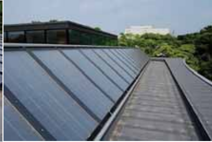
太陽光集熱パネル (太陽熱利用空調システム)
