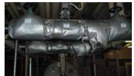
歯学部棟熱貯湯槽廻り
