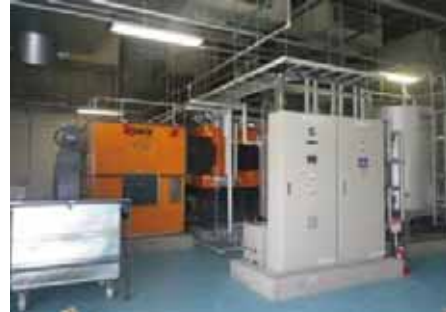
▲木質チップバイオマスボイラー
