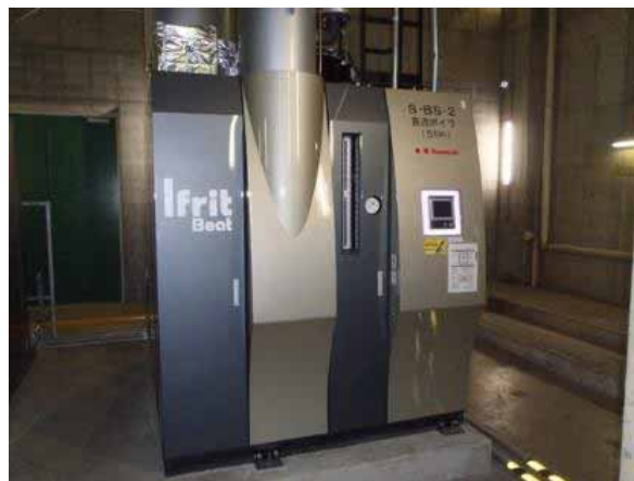
大型貫流ボイラー
