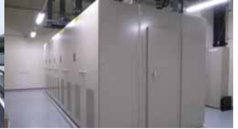
高効率変圧器やリチウム蓄電池を納めたキュービクル
