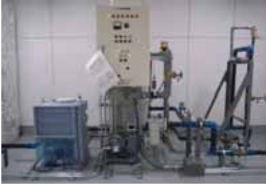
雨水利用のためのろ過装置
