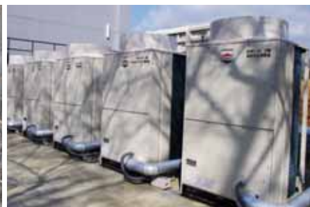
高効率空調機
