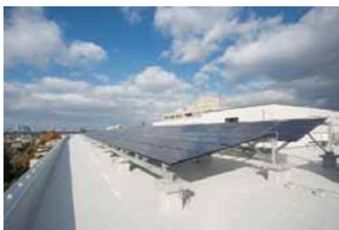
写真4: 太陽光発電(52kW)
