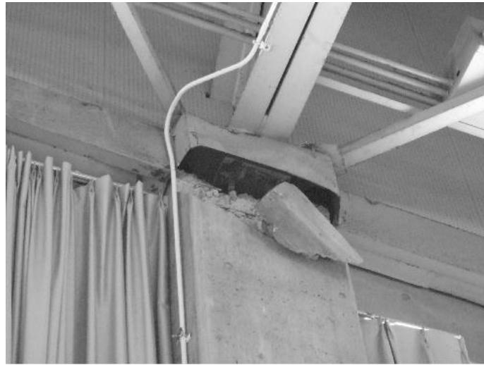
写真 4.1 定着部における側方破壊の例
