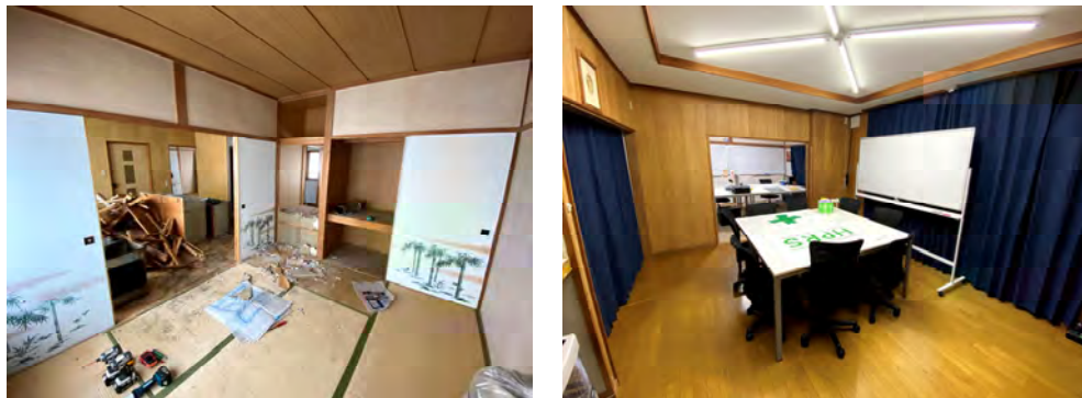
付帯建物の教職員住宅を改修し管理事務所として活用
