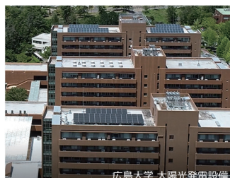
広島大学 太陽光発電設備
