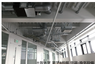
大阪大学 薬学4号館 空調・換気設備
