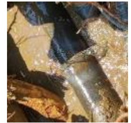
▲給水管の破断
