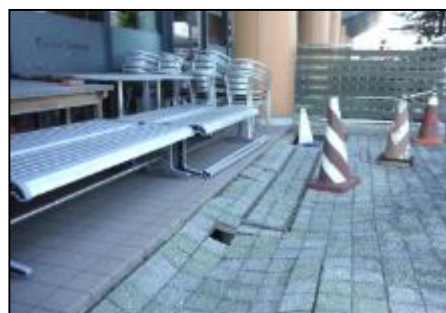
地震による外構破損
