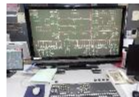
電気設備の運転・監視・制御を行う中央監視施設
