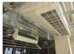
災害時にも利用可能な体育館の空調・換気設備
