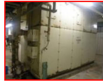
JT-60整流器棟空調機
