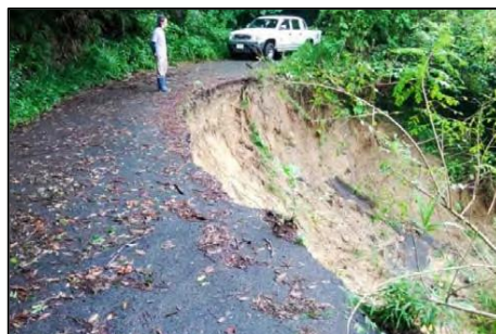
大雨による法面崩壊
