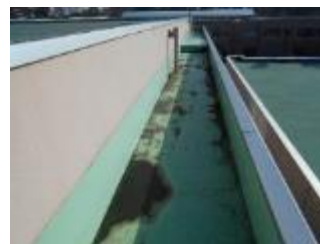
屋上防水の劣化
