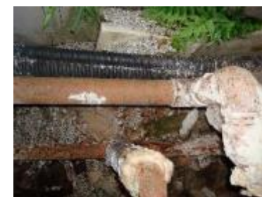
排水設備 (劣化状況)
