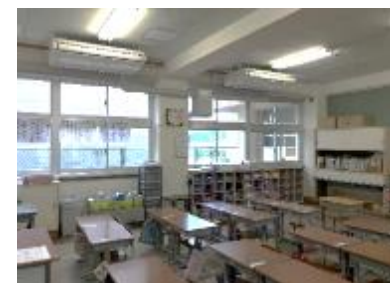
空調設備・換気設備を備えた教室
