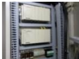
空調自動制御システムの更新
