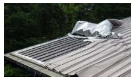
体育館屋根が損傷（漏水が発生）
