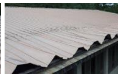
屋根全面が波打っている
