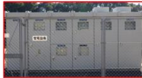
給水施設受変電施設
