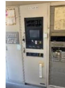
火災報知設備
