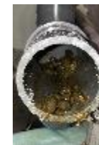
動物実験施設 排水管の 糞尿詰まり
