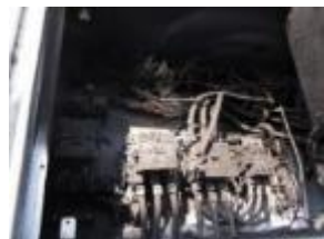
空調（チラー）の配線劣化による焼損
