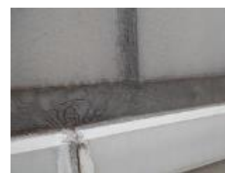
外壁タイルの浮き
