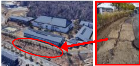
構内道路に発生した地割れ
