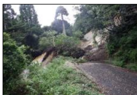
大雨による林道崩落
