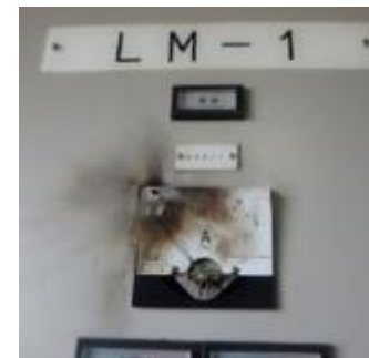
配電盤がショート
