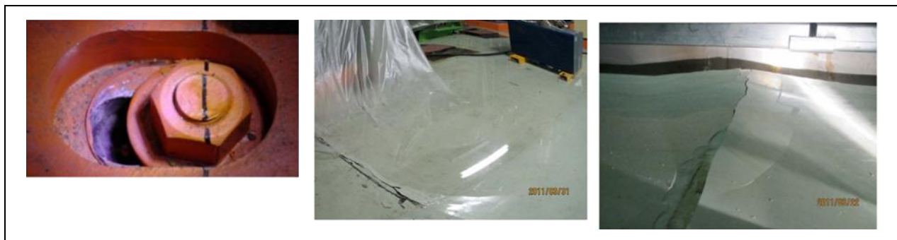
図 96 地震により被害をうけた施設例(左からエキスパンションジョイントにかかる電磁石ベースプレート、エキスパンションジョイント(漏水、床面盛り)
