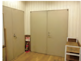
施設内の連絡扉
