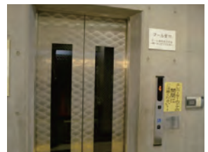
プール専用のエレベーター
